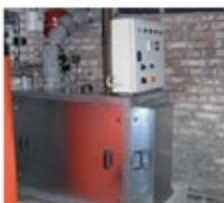
Die Vorteile von Blockheizkraftwerken: Hoher Nutzungsgrad und hohe Umweltverträglichkeit.
