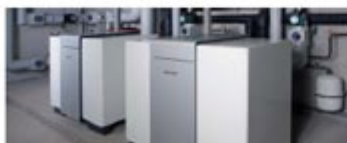
Gerade bei größeren Gebäuden reißt sich die Nutzung regenerativer Energiequellen wie z. B. Wärmepumpen. Die Wärme der Erde und der Sonne anzuschöpfen, ist einfacher als viele denken. Und mit der Reduzierung der CO 2 -Emissionen leisten Sie einen wertvollen Beitrag für die Umwelt.
